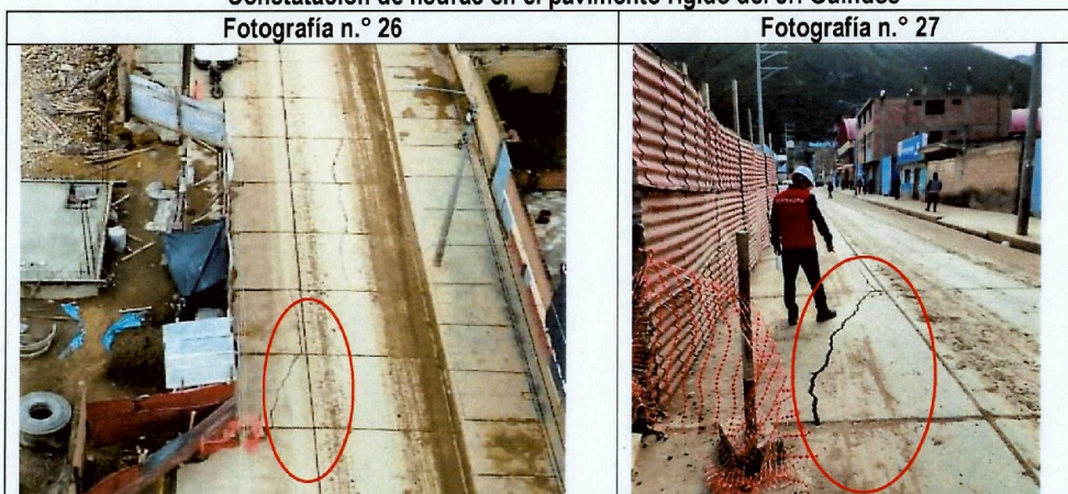
Fotografías n.ºs 26 y 27 Constatación de fisuras en el pavimento rígido del Jr. Guindos
