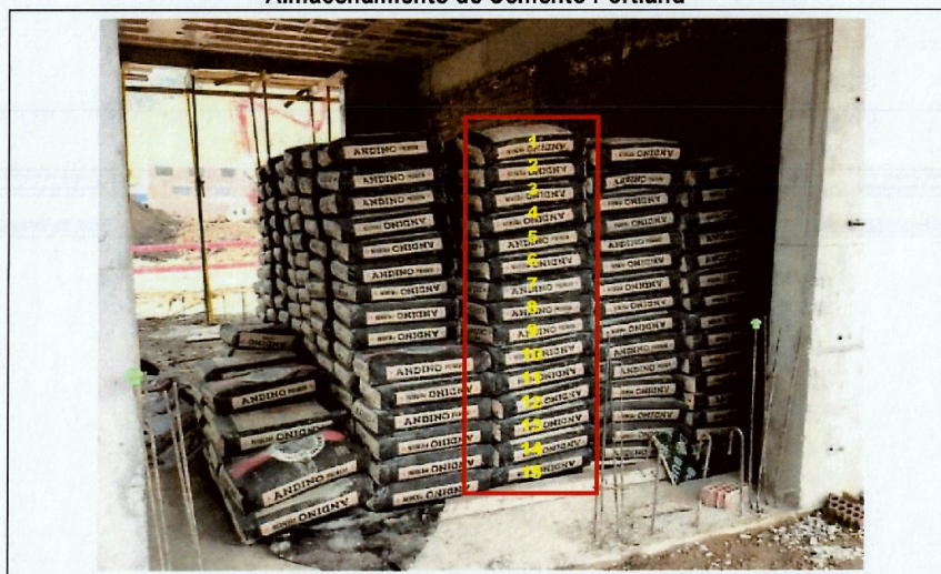
Fotografía n.º 33 Almacenamiento de Cemento Portland
