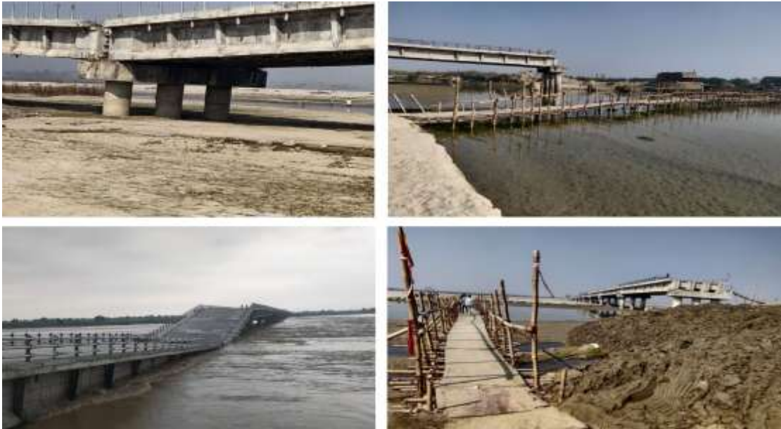
निर्माण कार्य सम्पन्न नहुँदै बाढीबाट क्षतिग्रस्त कमला पुल
