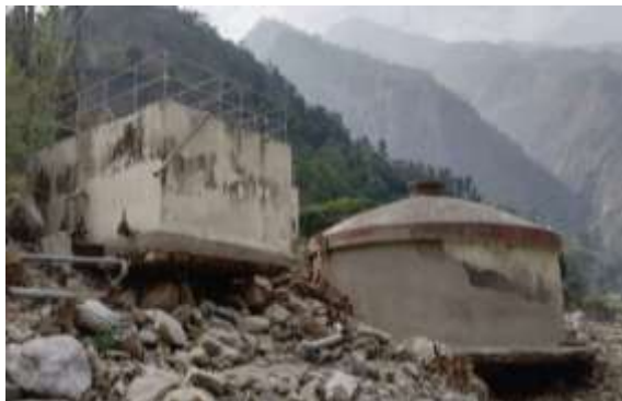
बाढीबाट क्षतिभएको पहिलो ट्याङ्की र फिल्टरिङ युनिट
