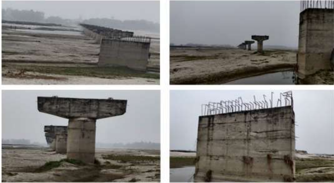
सब स्ट्रक्चरको कार्य सम्पन्न भई रुग्ण अवस्थामा रहेको बाग्मती पुल
