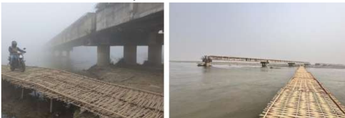
निर्माण कार्य रोकिएका रूगण अवस्थामा रहेको कन्काई पुल
